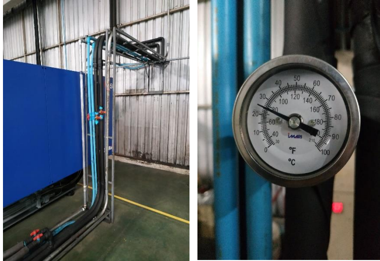
ภาพ 4.5 ระบบน้ำหล่อเย็น
